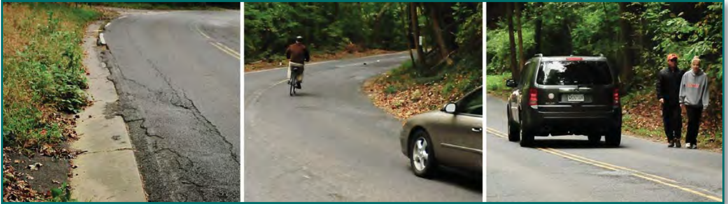
La vía existente presenta deterioro en el pavimento y drenaje deficiente y carece de seguridad para ciclistas y peatones.
